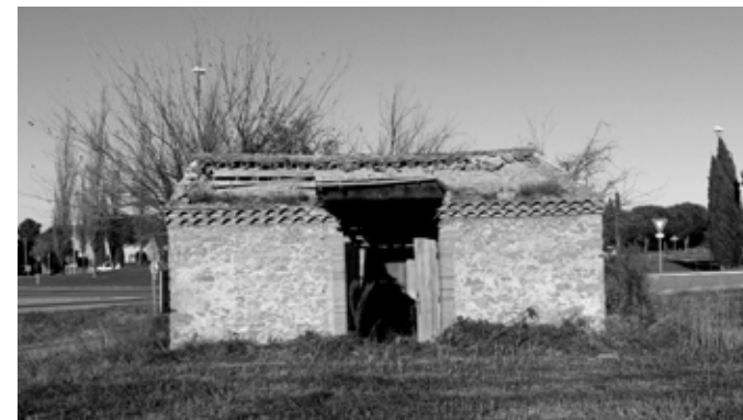
Loge de vigne dont la toiture s'est effondrée
